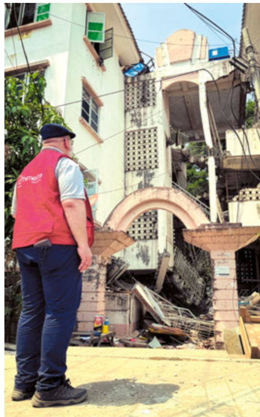
Nach dem Erdbeben in Myanmar 2025 ging es zunächst darum, die Sicherheitslage zu überprüfen
